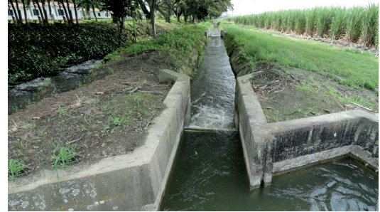
Estructura de división de agua.
