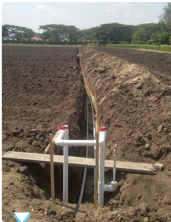
Instalación de riego en lotes experimentales.
