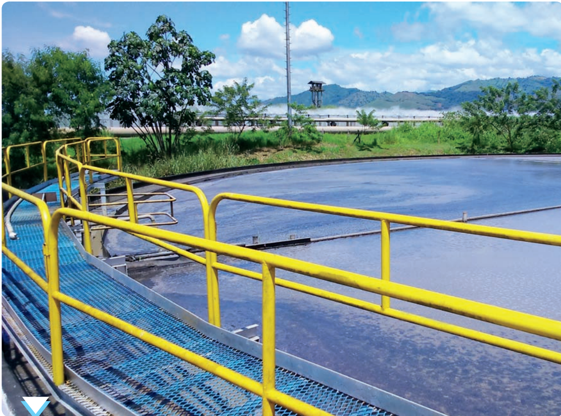
Sistema de tratamiento de agua de lavado de caña. Ingenio Risaralda.
