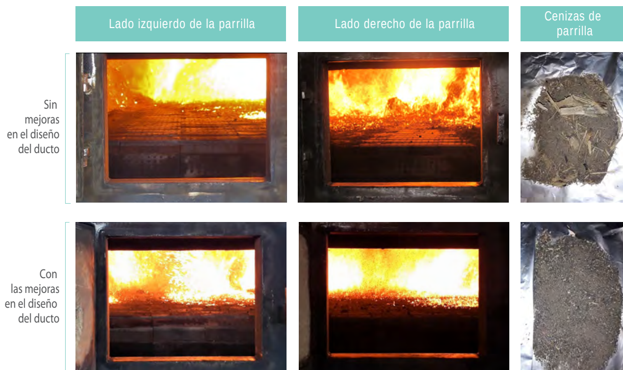
Figura 35. Combustión en la parrilla antes y después de la implementación de las mejoras.
