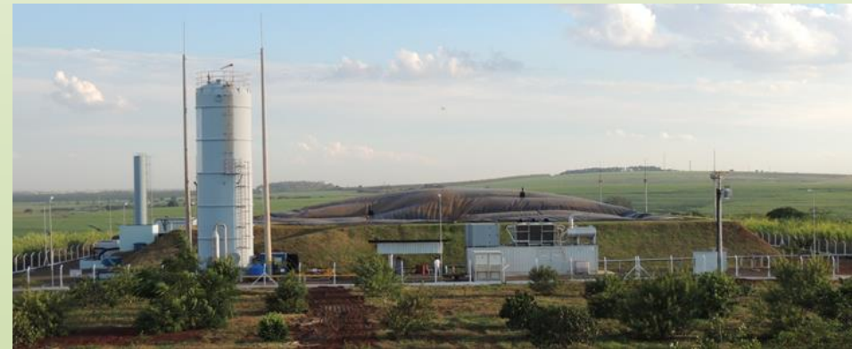
Biodigestor instalado em 2012 (lagoa coberta com lona) na Usina Ester, Cosmópolis, SP ( desativado ).
