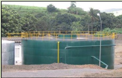
Biodigestor instalado em 2.000 na Destilaria Inexport, Cabo de Santo Agostinho, PE. ( desativado )
